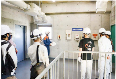
●自動火災報知設備の見学
